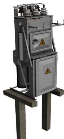
Рис. 9 Трансформаторная подстанция 10/0,4 кВ
